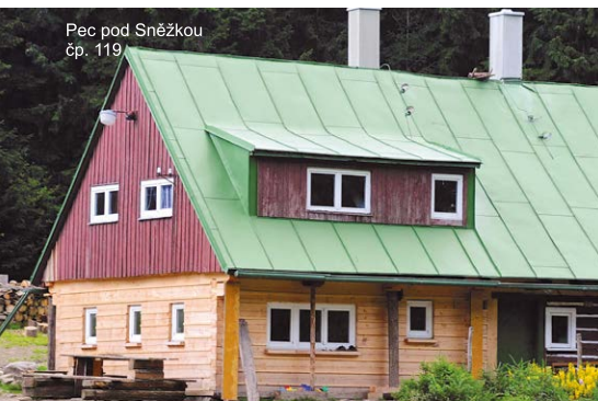
Okna nevhodného typu, ve štítu i na delší straně přizemí také nevhodného tvaru.
