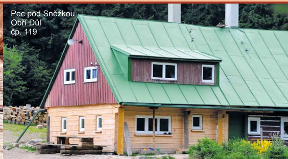
Chybná výměna roubení bez spár s osazením nevhodných oken a nevhodné prosvětlení podkrovní plochým vikýřem.
