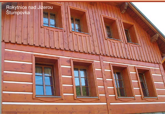
Příliš hluboko ve zdi utopená okna.
